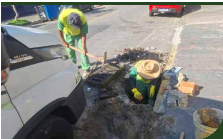
Reparo no piso mosaico na Avenida Presidente Wilson, no José Menino
