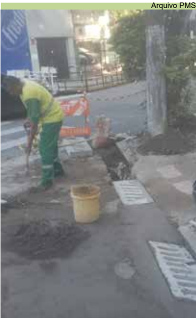
Instalação de boca de lobo na Rua Jorge Tibiriçá, em frente ao número 1, no Gonzaga
