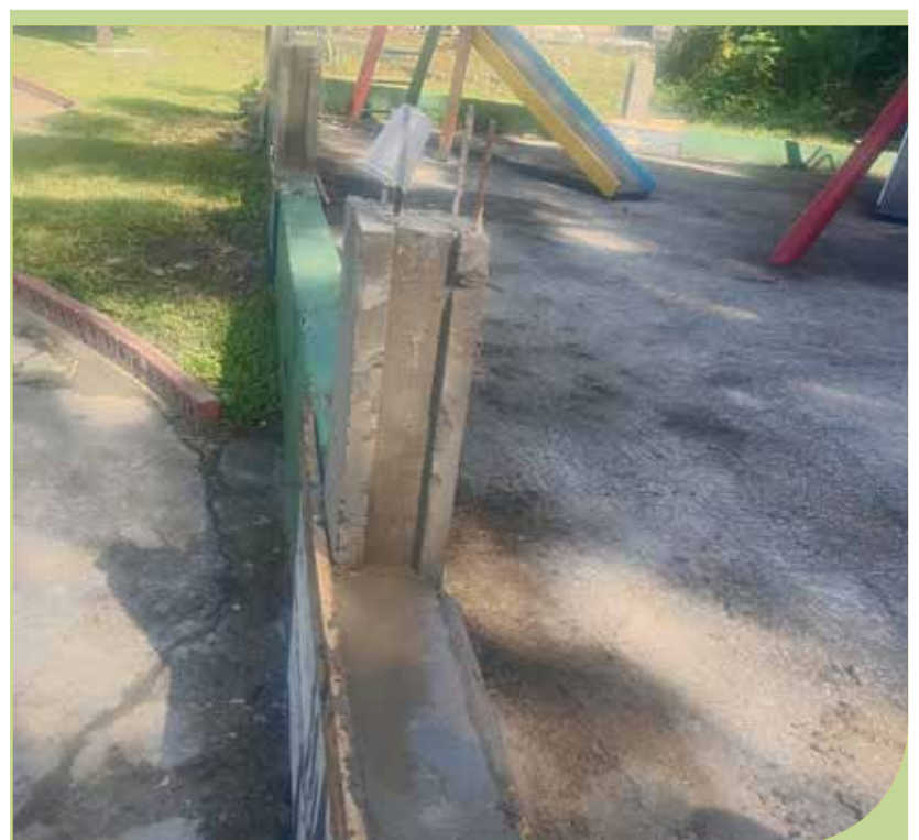
Concretagem das bases de pilares para fixação na Bica do Ilhéu, no Bom Retiro
