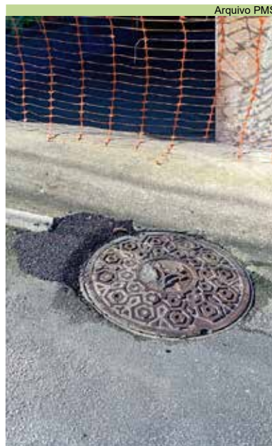
Manutenção asfáltica em poço de visita na Rua Amália Rodrigues no Nova Cintra
