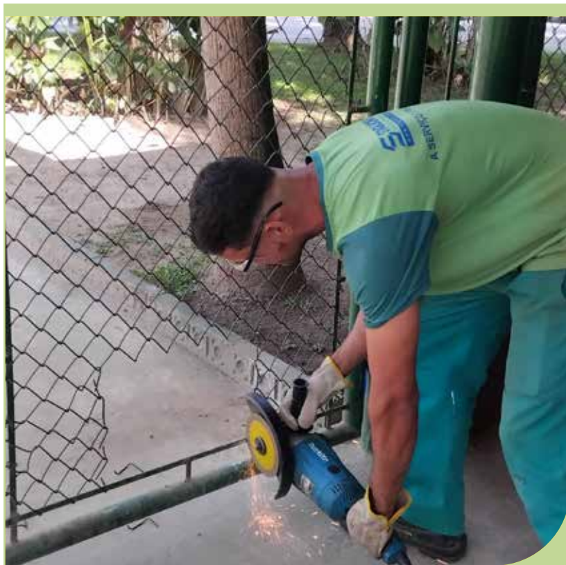
Instalação de portinhola de acesso para cães na área de espera da veterinária do Caruara.
