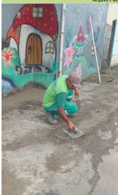
Reparo em calçada na Rua Doutor Flor Horácio Cyrillo, no bairro Castelo
