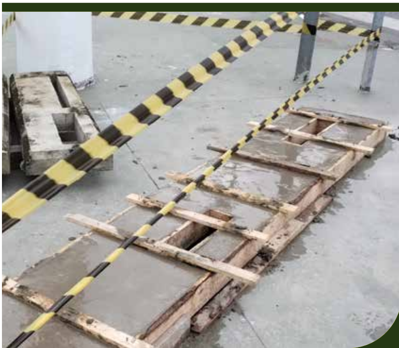
Construção de base para fixação de totem na esquina da Francisco Glicério e da Bernardino de Campos
