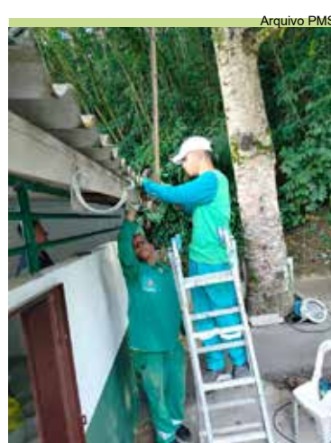
Instalação de calha na entrada da base de apoio do Monte Cabrão
