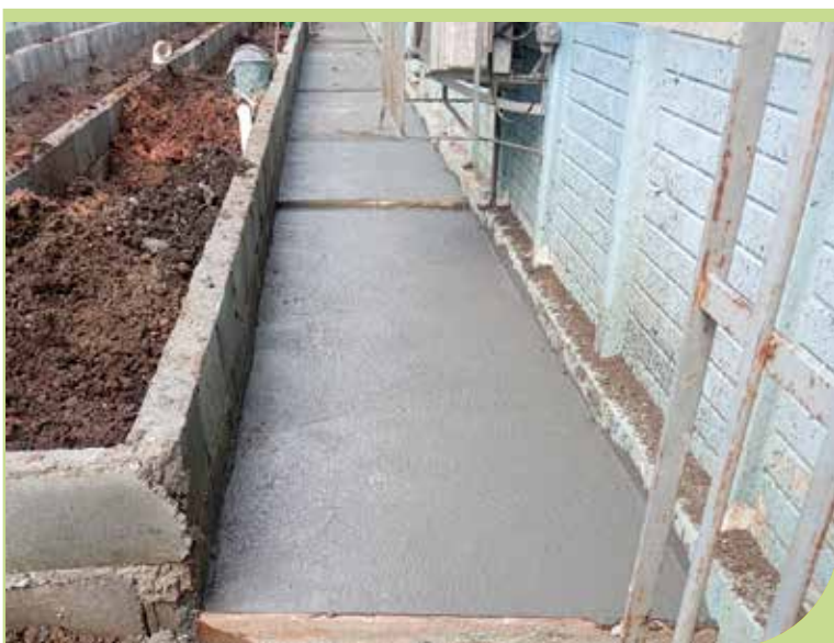
Concretagem de calçada no entorno da horta na UME Judoca Ricardo Sampaio, no Caruara
