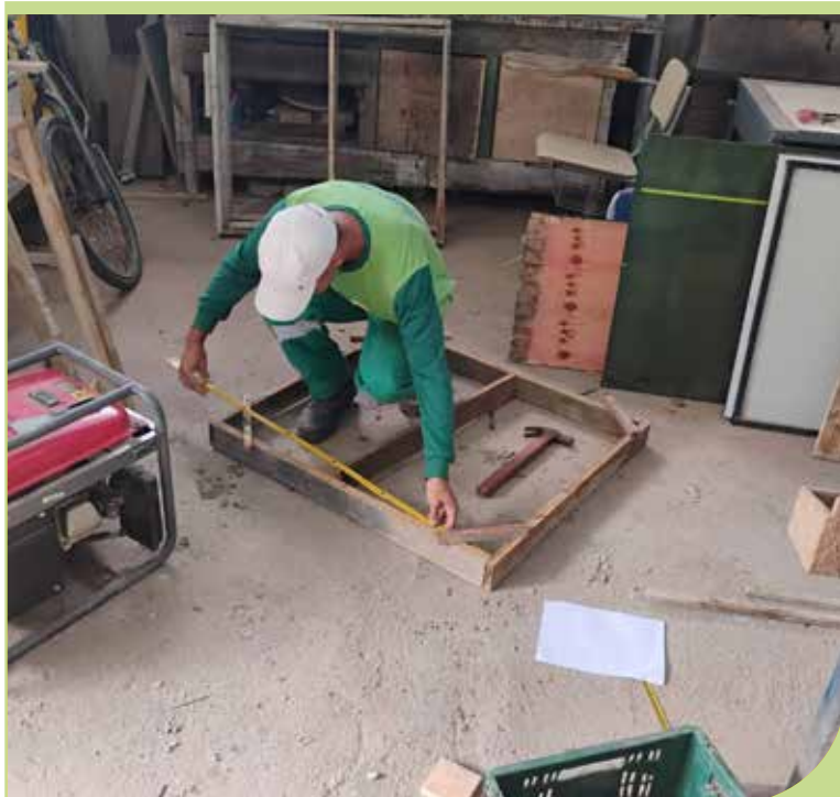
Montagem de formas para tampas das caixas de passagem da Rua Caramuru, no sentido Travessa Antônio Mineiro
