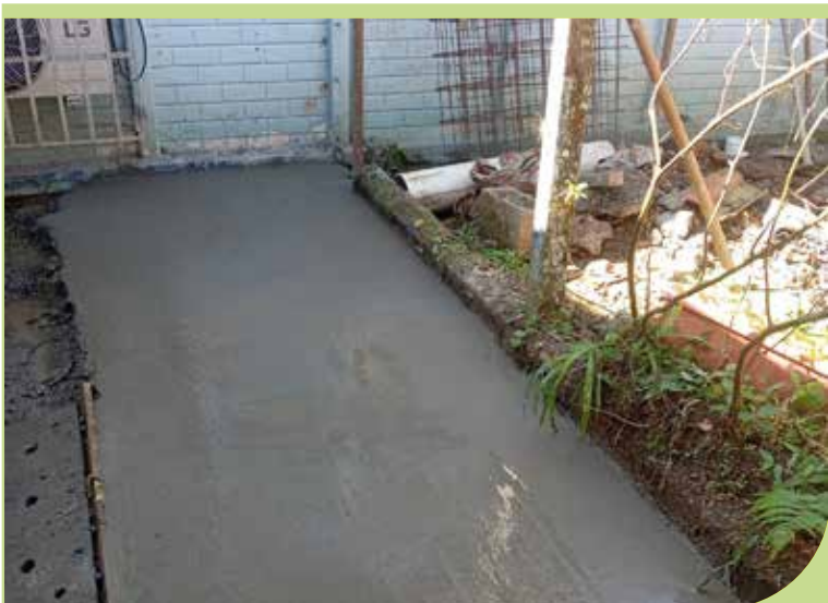
Concretagem da rampa de acessibilidade da horta na UME judoca Ricardo Sampaio, no Caruara
