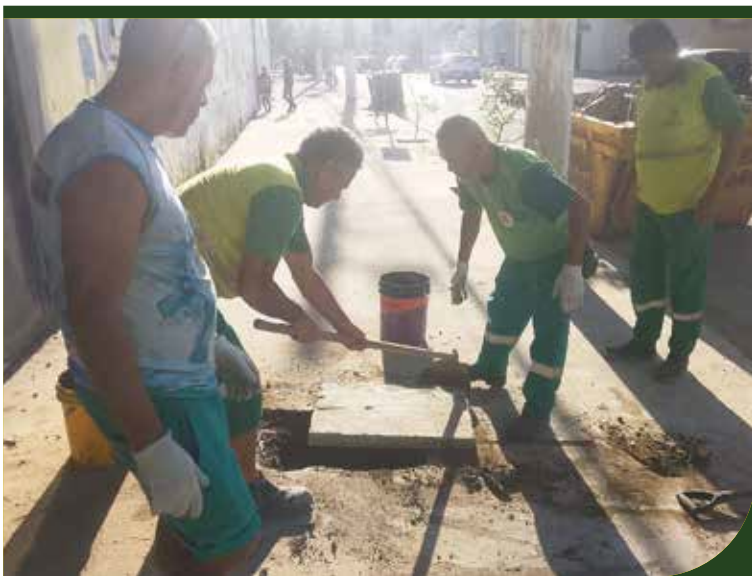
Troca de tampa de ferro por concreto na Rua Dom Pedro I, na Vila Belmiro
