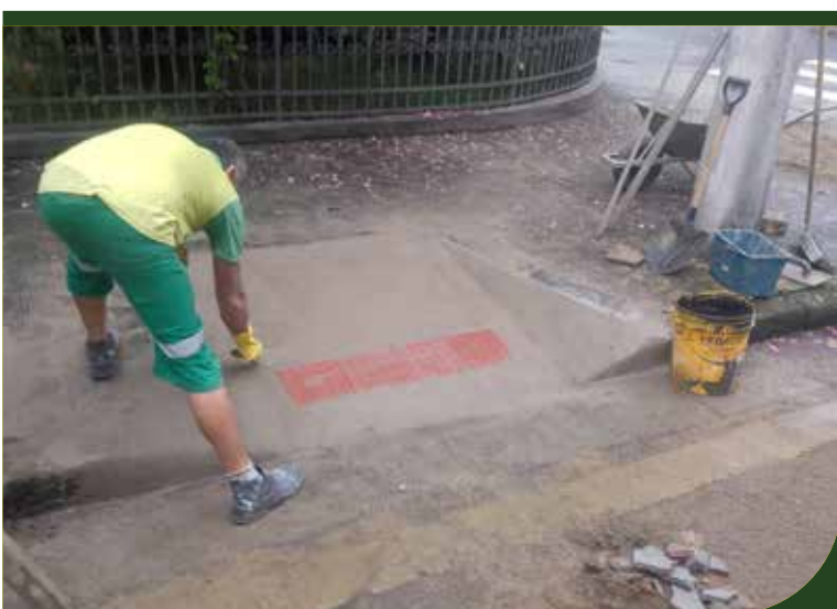
Novas rampas acessíveis foram instaladas na Rua Enguaguaçu, na Ponta da Praia
