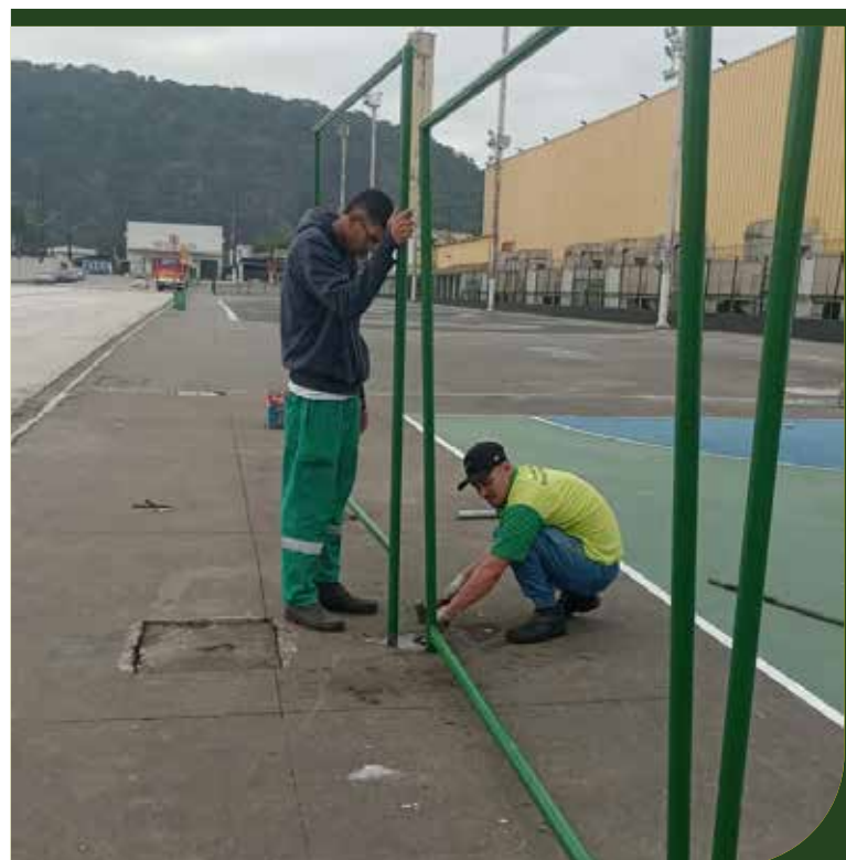
Início da soldagem dos quadros de alambrado da quadra esportiva ao lado do bloco A no Centro Cultural
