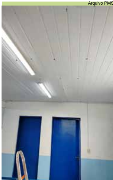
Reparos no forro de uma das salas da UME Ilha Diana
