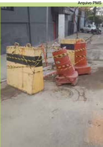
Conserto de grelha de boca de lobo: Rua Francisco Meira com Praça Nicolau Geraigire
