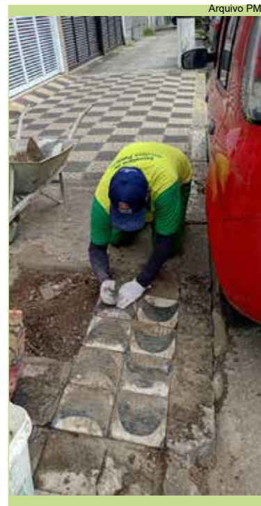
Reparo em calçada na Rua Princesa Isabel, em frente ao número 11
